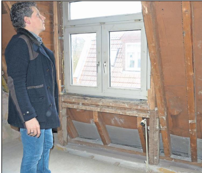
Bald kommt eine neue Dämmung: Gewoba-Prokurist Olaf Neumann führt durch das Haus in der Torumer Straße 4.
