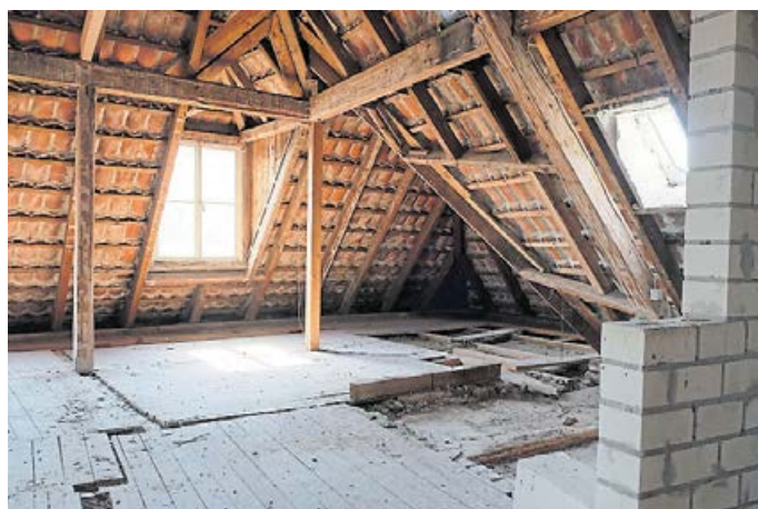
So sah das Dachgeschoss vor der Sanierung aus: der Blick fiel gleich auf die Dachpfannen, keine Isolierung. BILD: HASSELER
