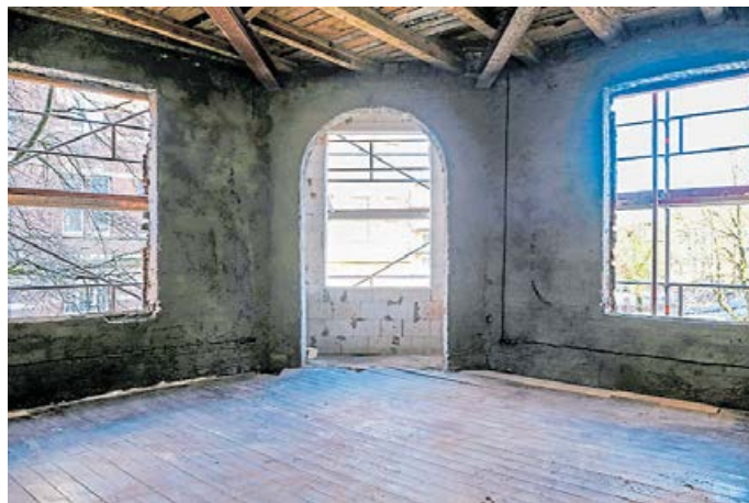
Da die Erker absturzgefährdet waren, wurden sie komplett abgerissen und neu gebaut. BILD: HASSELER
