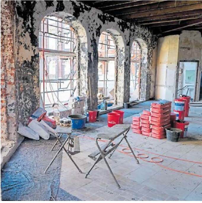
Aus der „Haifischbar“ wurde beim Umbau alles entfernt, so dass nur die nackten Wände übrig blieben. BILDER: HASSELER
