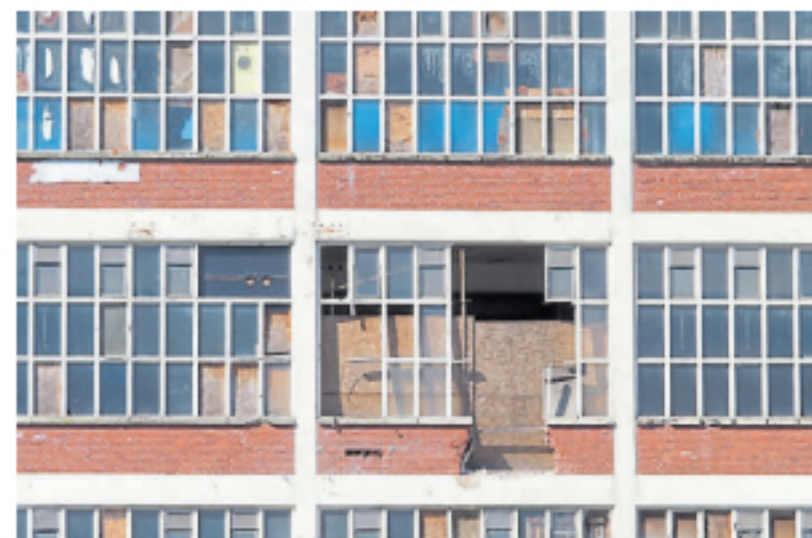
Nahaufnahme von der Turmfassade aus Richtung Hansastrasse: Etliche Glasschei-
