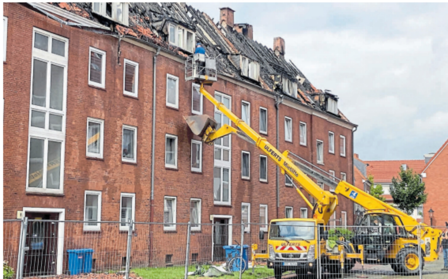
Jetzt beginnen die Aufräumarbeiten in der Emdener Innenstadt: Das betroffene Mehrparteienhaus in der Klunderburgstraße ist seit dem Dachstuhlbrand am Freitag nicht mehr bewohnbar.
