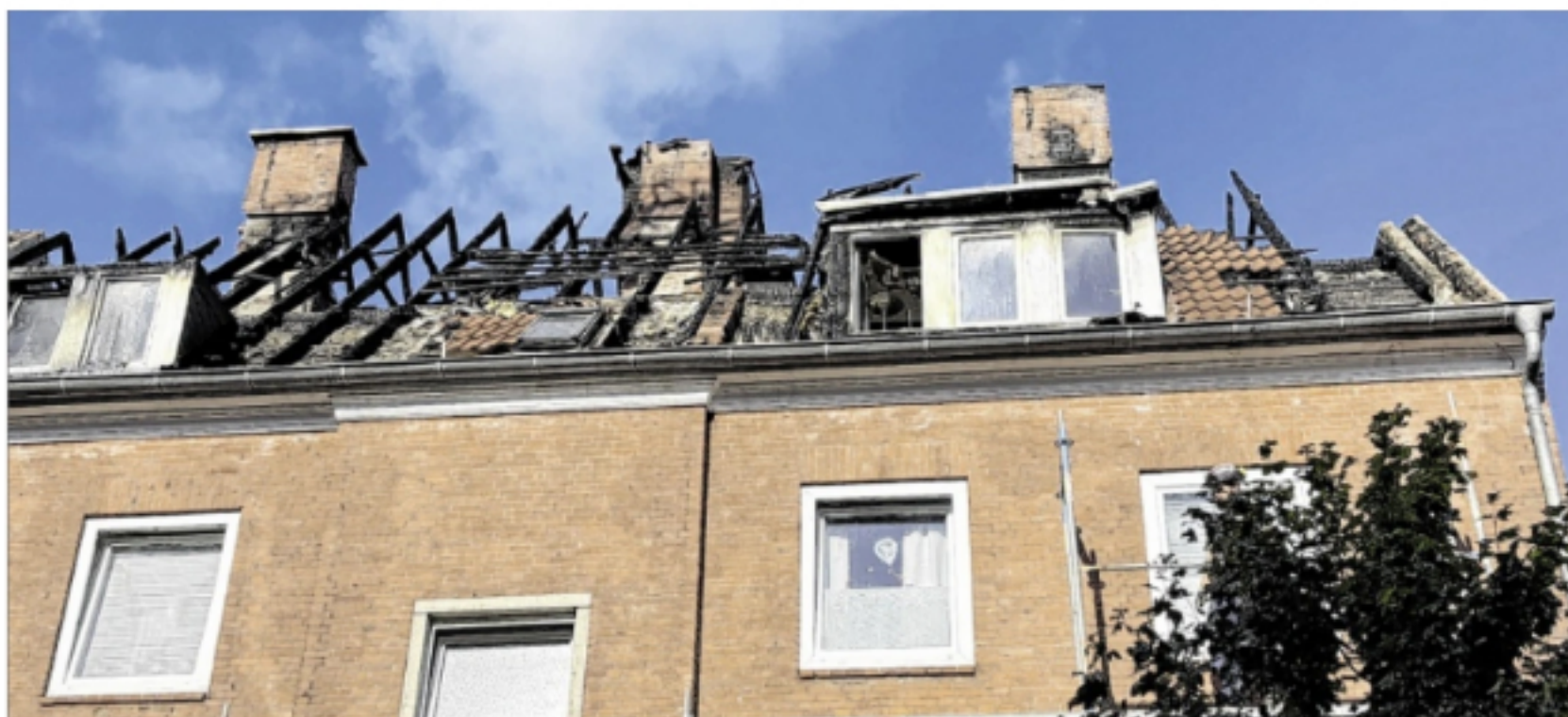
Im Dachstuhl soll der verheerende Brand ausgebrochen sein und sich schnell übers Dach auf die anderen Häuser ausgebreitet haben.
