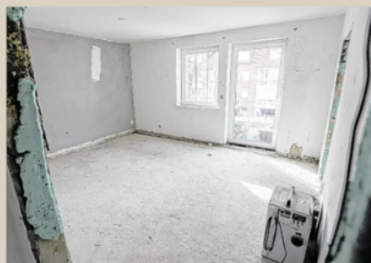
Die Wohnungen sind alle entkernt. In einigen steht ein Lufttrockner.
